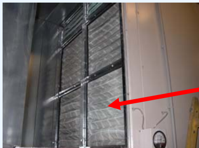
Filter beim Einbau falsch gedreht
